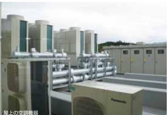
屋上の空調機器
