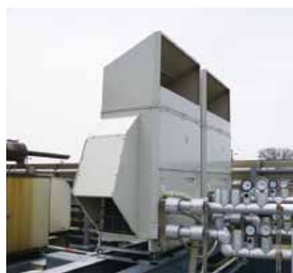
自然冷媒ヒートポンプ給湯システム
