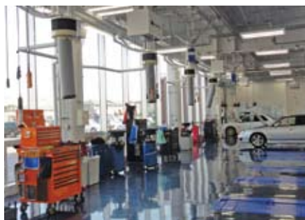
ファンコイルの個別運転で働きやすさが増します。
