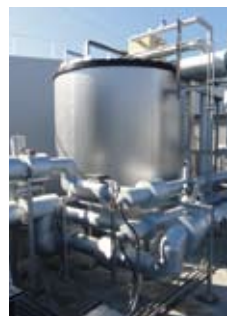
氷蓄熱タンク
