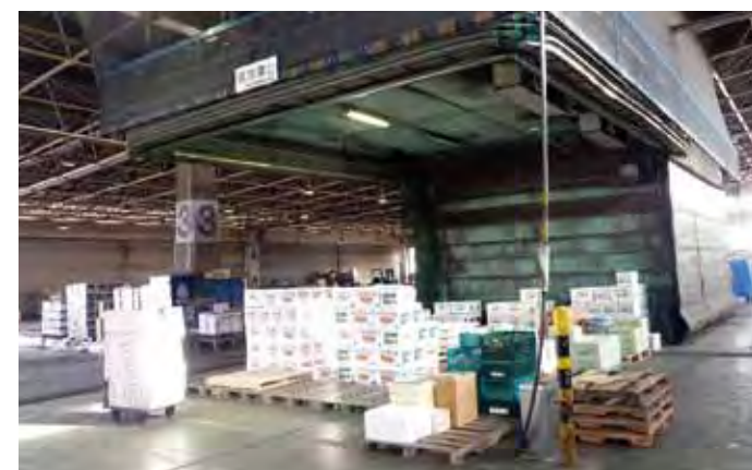
青果市場内にある既存の冷蔵装置。(天井からジャバラが下降し商品を冷蔵する。)
