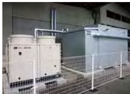
蓄熱冷凍機20HP×2台・蓄熱槽14㎡
