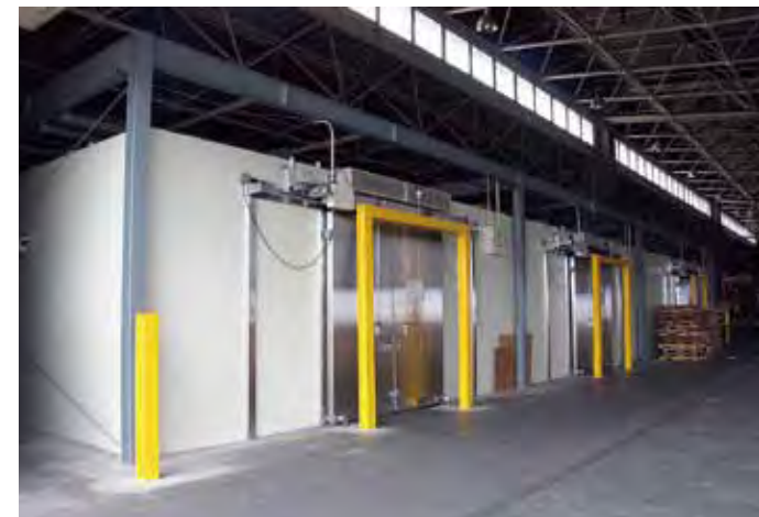
ウルトラ・エコアイスシステムが導入された冷蔵庫の外観
