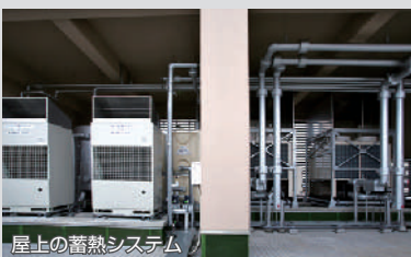
屋上の蓄熱システム
