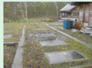
山小屋の脇に設置された合併処理浄化槽
