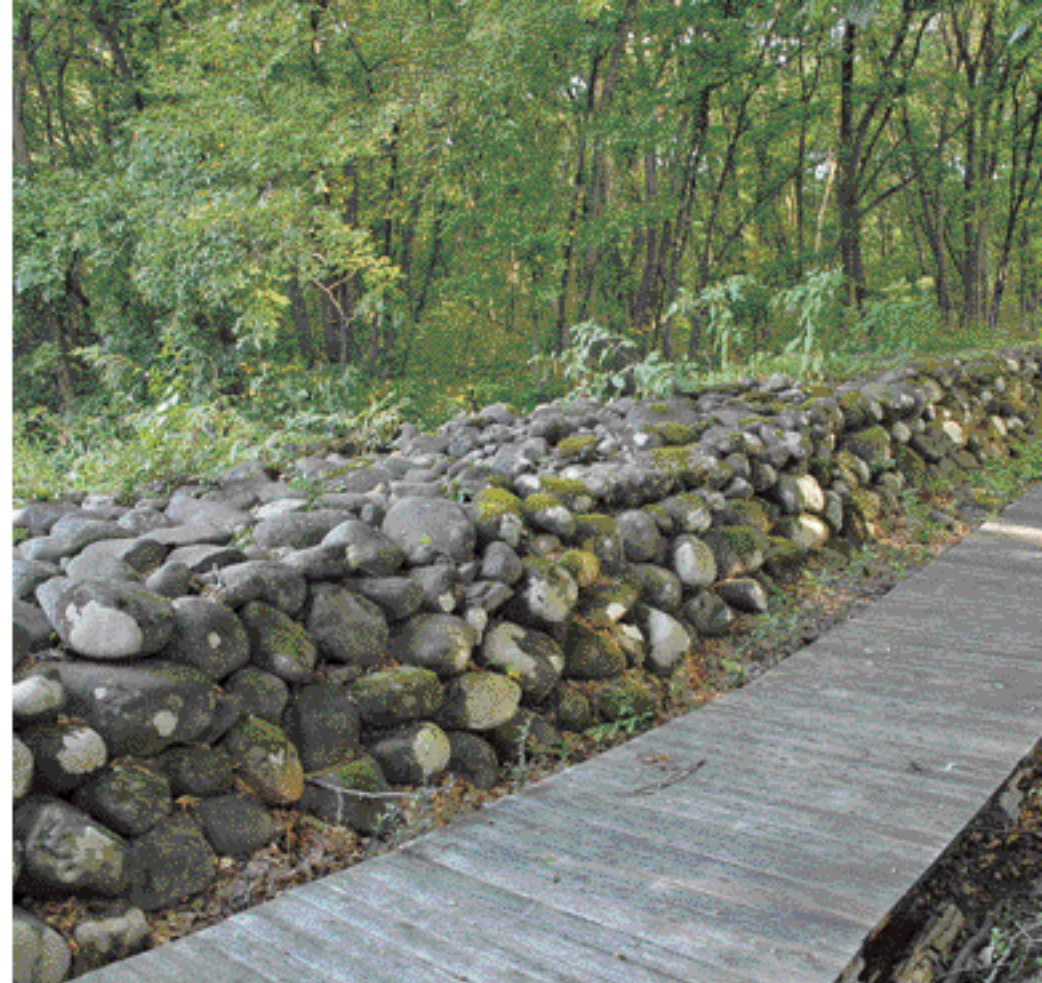
直江石壁 松川(最上川)の上流、海老ヶ沢(えびがさわ)橋の上・下流に続く直江石壁。洪水を防ぐには是非ともここに堤防を築くべきと判断した兼統が、大規模な築堤を計画したと伝えられている
