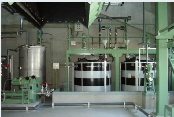
薬品注入設備
