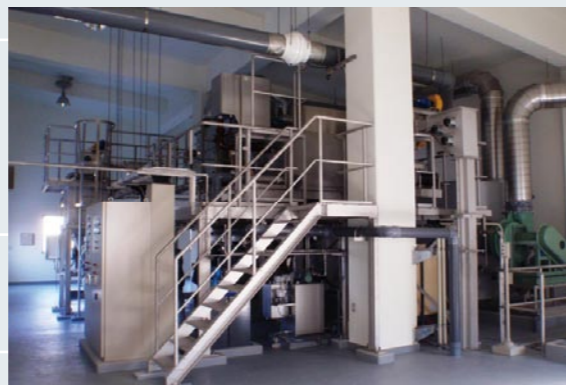
汚泥炭化設備
