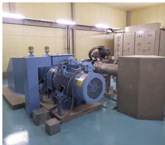
(箱島湧水発電所)
