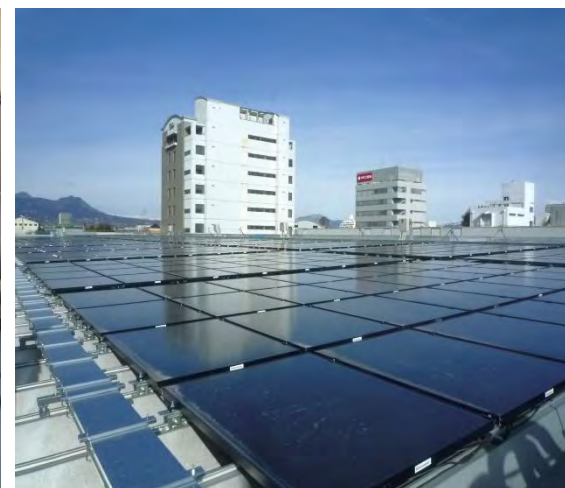
(ヤマト第二別館 太陽光パネル)
